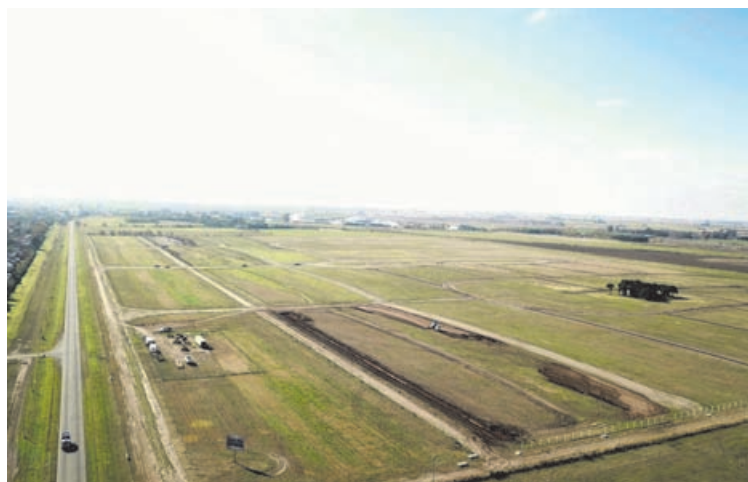
HormiRed es la firma que está realizando el movimiento de suelos. (TIERRA DORADA)
