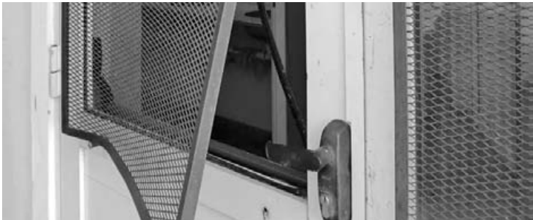
Los ladrones forzaron la reja de una ventana para ingresar al edificio escolar.
