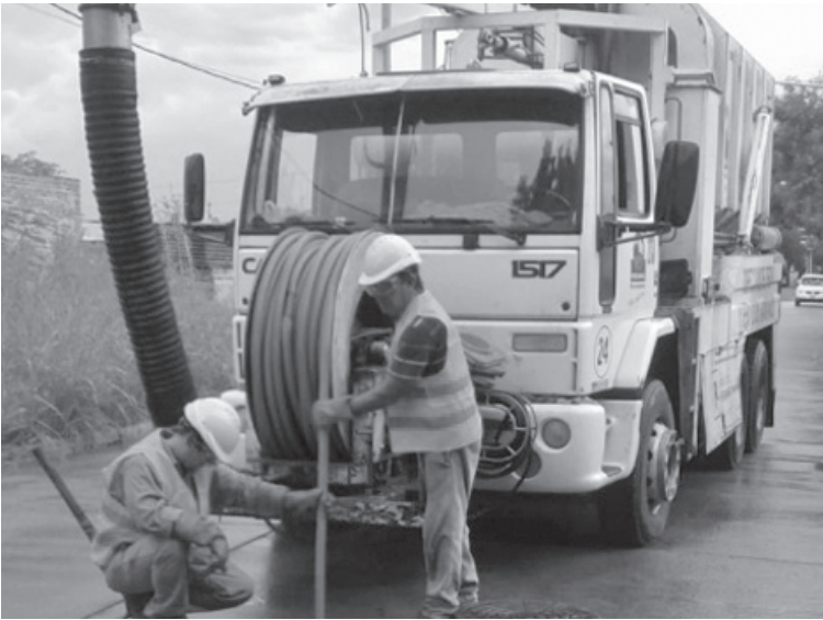
En varias zonas de la ciudad generalmente el personal tiene que trabajar por las obstrucciones en las cañerías.
