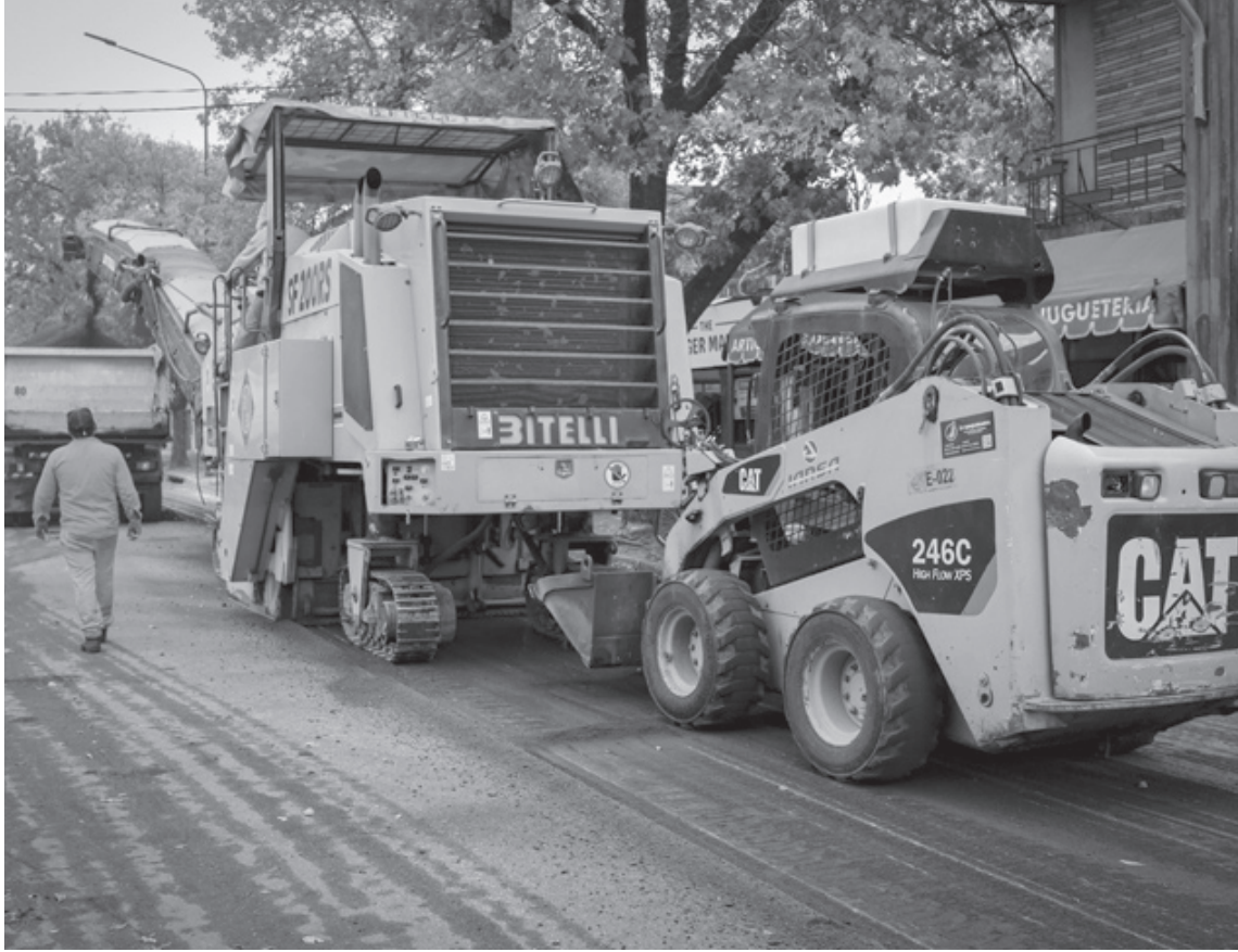
Una vez terminado el reasfaltado, se iniciará la señalización horizontal para dejar en óptimas condiciones todo el tramo de avenida Yrigoyen. (LA OPINION)
